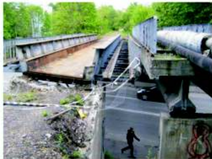
Wiadukt po w skotorówce zagraża bezpieczeństwu mieszkańców.
